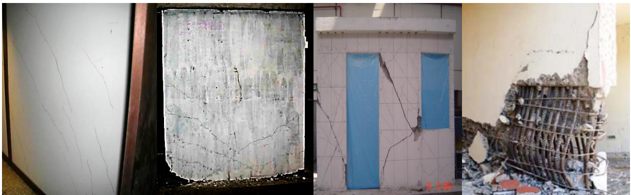
Figura 17. Ejemplos de daños en muros de concreto armado.
