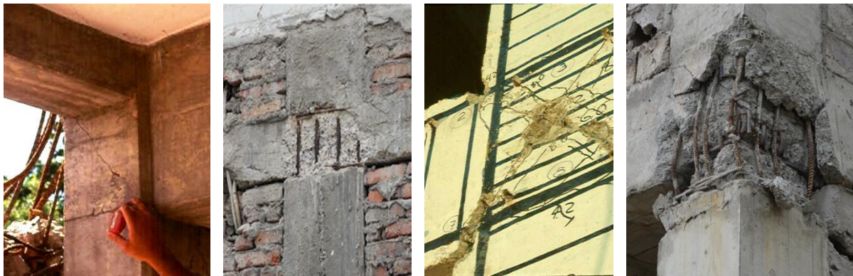
Figura 14. Daños en juntas (nodos) de concreto armado.
