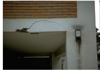
2. Daño Moderado Caracas 1967, (NISEE, 2021)
