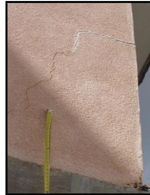
Figura 4.10.47.- Grieta en el volado del nivel 1 del Edificio Norte.
