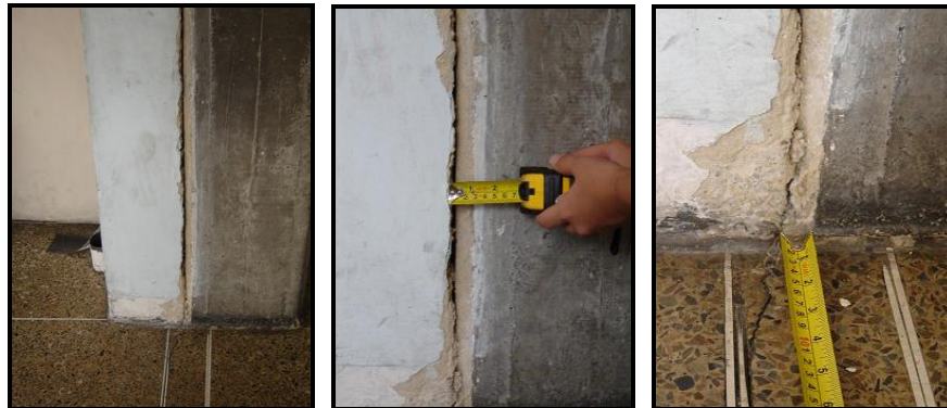
Figura 4.10.53.- Junta del edificio Sur en el nivel 3. En las imágenes se observa la gran separación localizada en el último piso del plantel.
