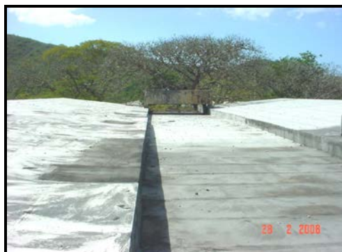
Figura 4.8.2. Ausencia de uno de los dos tanques de agua
