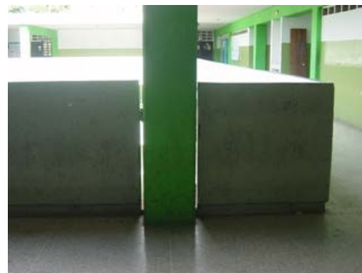
Figura 4.17.9.- Pared interior de concreto, separada de las columnas.
