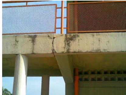
Anexo 4.16.5.- Agrietamiento en la junta de unión entre el pasillo y el Módulo 4.
