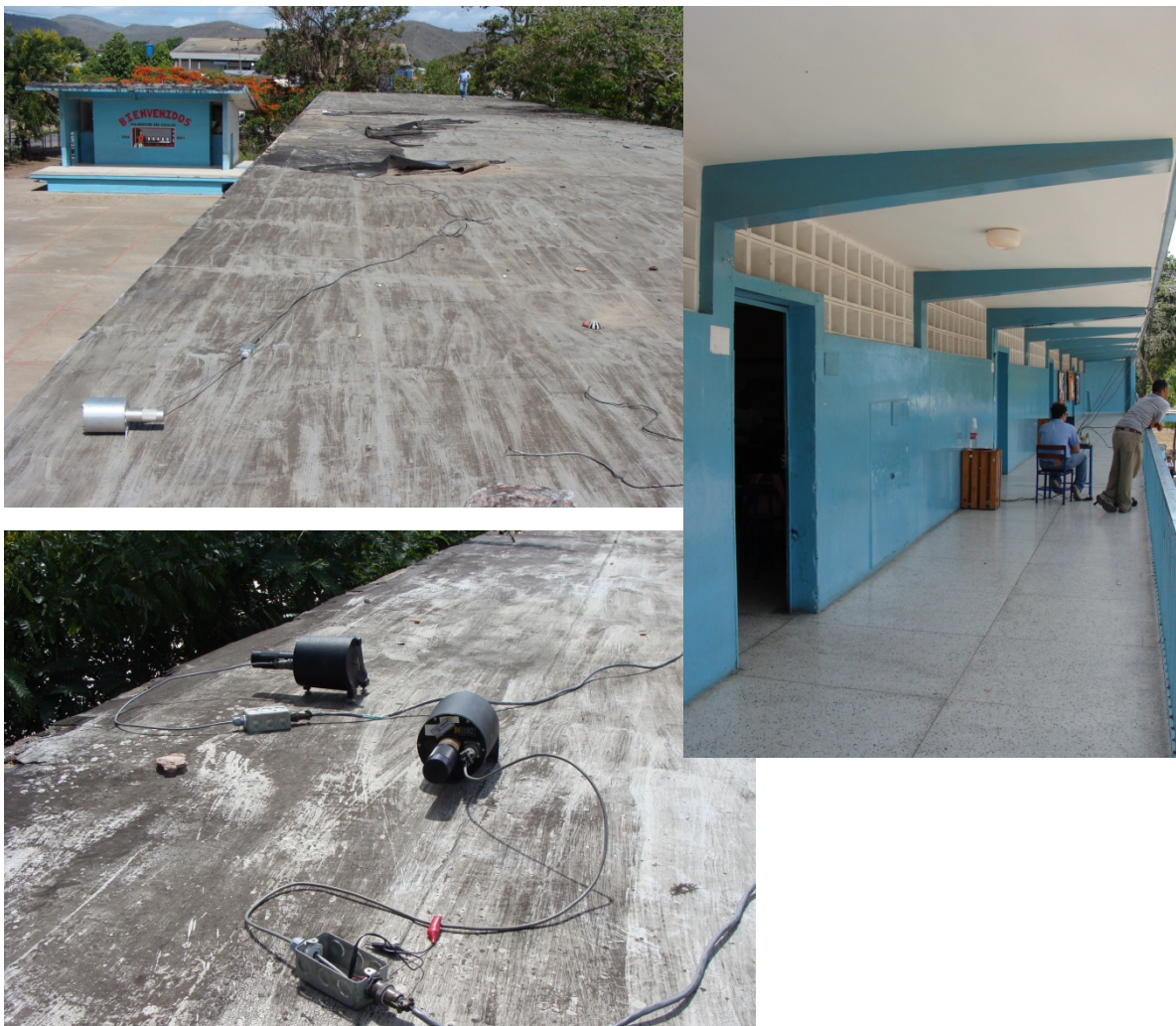
Figura 5.2. 77.- Sensores Ch 5 y Ch 6 (inferior), vista de la losa de techo (superior), Vista desde el segundo nivel (derecha).
