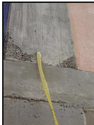
Figura 4.10.48.- Grietas en la columna que sostiene parte del volado del nivel 1 del Edificio Norte.
