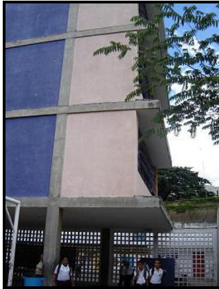
Figura 4.10.46.- Edificio Norte, el cual presenta grietas en el volado del nivel 1 y en la columna que sostiene dicho volado.
