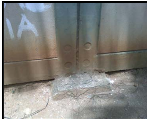
Anexo 4.15.5.- Fachada Norte, Unión Estructura-Fundación, edificio A.
