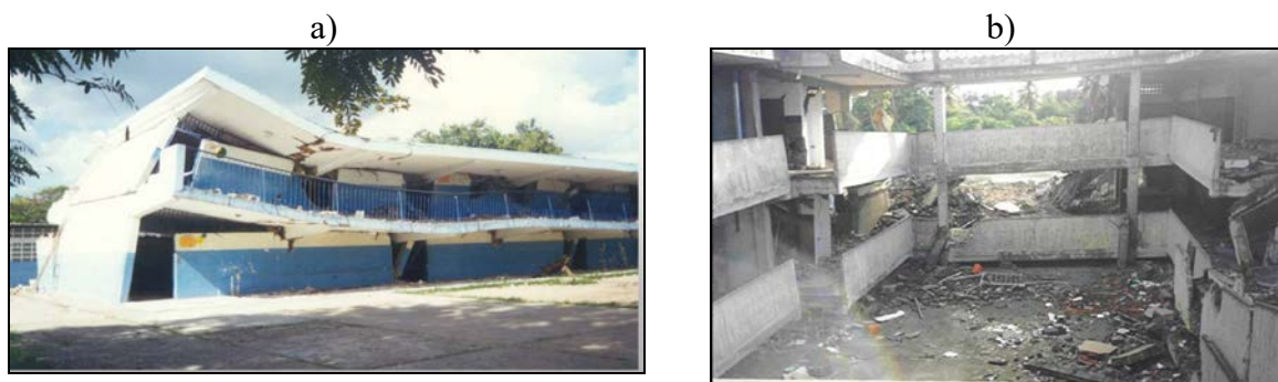
Figura 1.2. Escuelas colapsadas debido al sismo de Cariaco de 1997; a) Escuela Valentín Valiente (Antiguo I); b) Liceo Raimundo Martínez Centeno (Cajetón).
