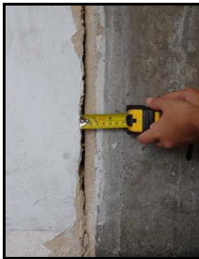
Figura 4.10.2.- Junta de construcción entre el módulo de la escalera y el edificio Sur de la U. E. N. Padre Sojo. La imagen pertenece al último nivel donde puede observarse la separación que presenta dicha junta.
