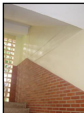
Figura 4.10.11.- Escaleras de acceso a los niveles superiores. En la imagen se puede apreciar la presencia de vigas altas en ambas direcciones. E. B. N. Fernando Peñalver.
