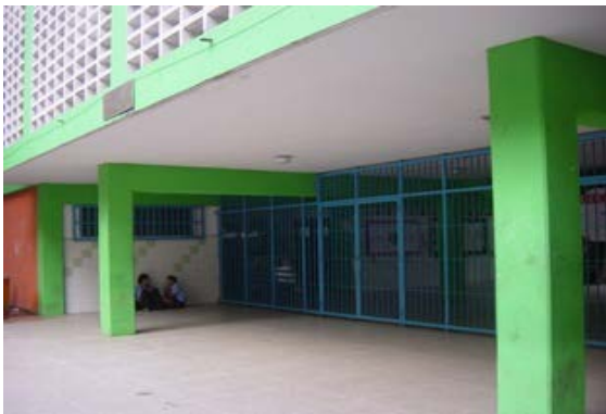
Figura 4.17.6.- Entrada principal (fachada este). Nótese la ausencia de vigas altas en dirección transversal.
