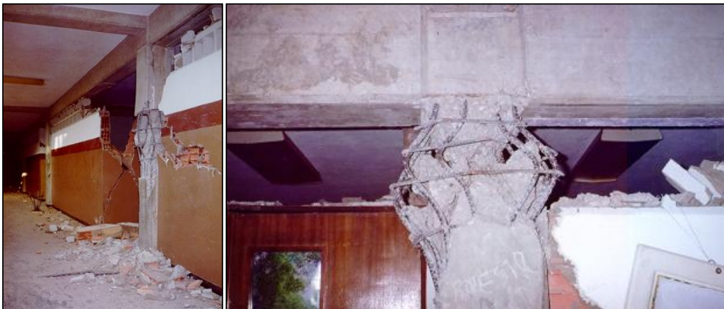
Figura 4.11.29.- Imágenes del colapso de la estructura del liceo Raimundo Martínez Centeno
