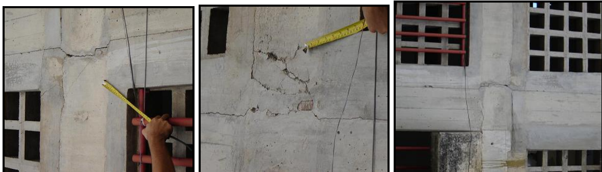
Figura 4.10.49.- Las tres imágenes fueron tomadas desde el patio central hacia el módulo de la escalera. En ellas se aprecian las grietas causadas por la separación natural a nivel de las juntas de construcción, por medio de las cuales se mantienen unidos los 3 edificios.
