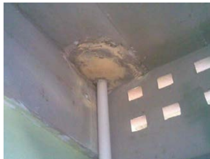
Anexo 4.16.17.- En todos los salones del Módulo 3 se puede ver, como la losa de entrepiso está deteriorada por el paso de un bajante de aguas de lluvia a través de ella.
