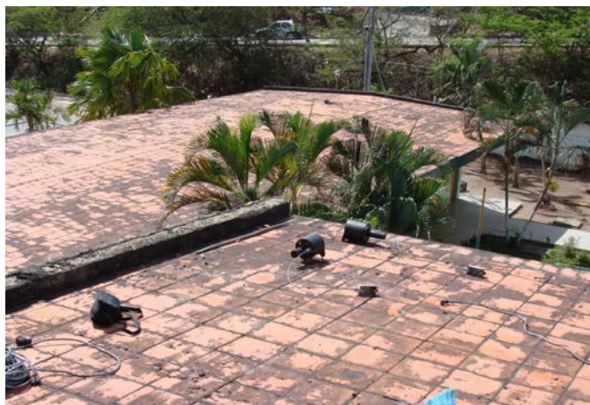
Figura 5.2. 51.- Vista de los sensores Ch 1 y Ch 2
