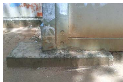
Anexo 4.15.6.- Esquina Noroeste, Unión Estructura-Fundación, edificio A.
