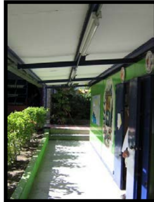
Figura 4.13.11 Edificación 1 pasillo de circulación
