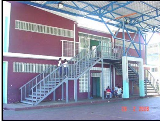
Figura 4.8.5. Escalera de emergencia metálica.
