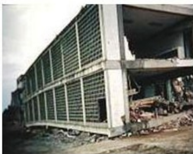
b) Después del terremoto; aplastamiento del primer entrepiso (Cortesía de E. Castilla)
