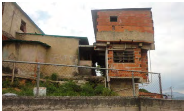
Figura 0.40 Edificación de vivienda popular, construida en forma empírica.
